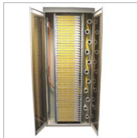
5b Optical distribution frame (ODF)
